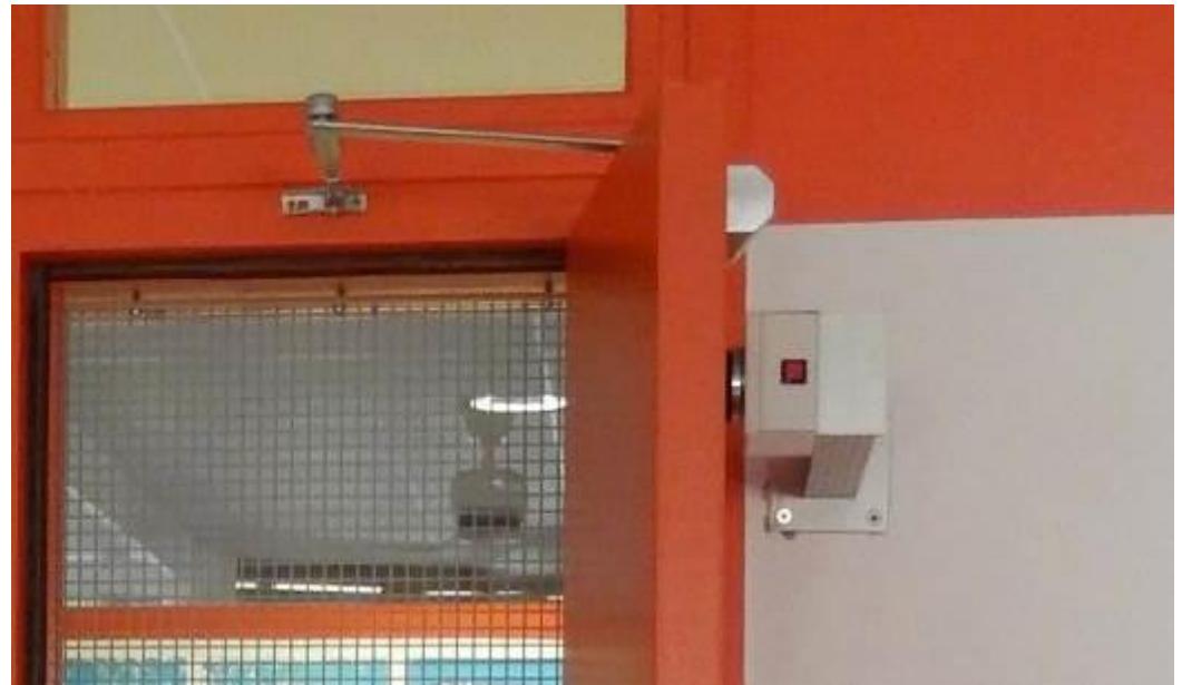
Porte avec système coupe feu pour la sécurité incendie
