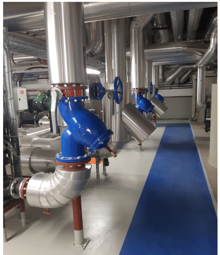
Centrale de production Smartseille 2 - Dalkia Smart Building
