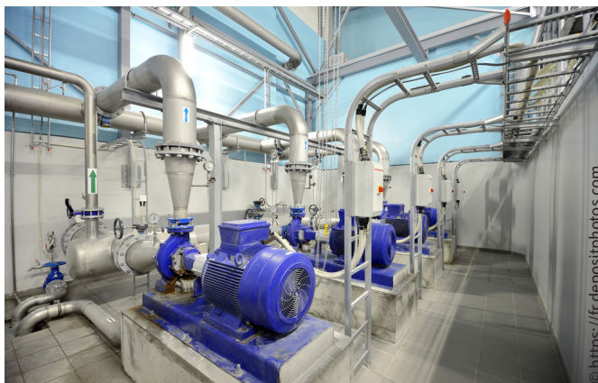
Pompes en chaufferie industrielle.
