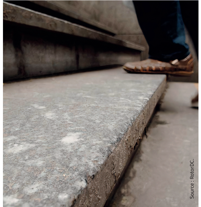
Un bel exemple de différenciation : l'arête de ces marches d'escalier en granit tend à s'user davantage aux zones de fortes fréquentations.
