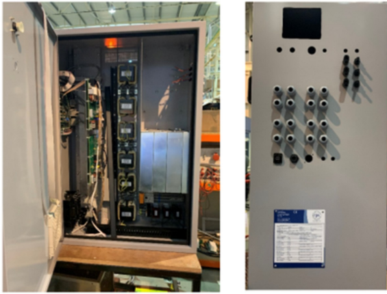
Convertisseur MIMO de la résidence Les Résédas.
