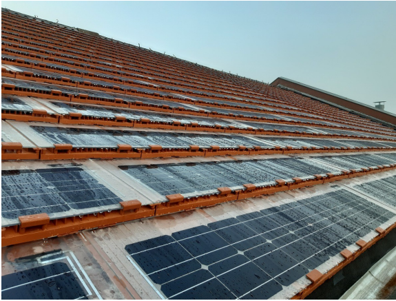
Tuiles photovoltaïque BIPV de la résidence Les Résédas.
